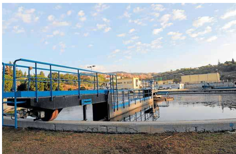
Depuradora de La Vibora, en Marbella. JOSELE
